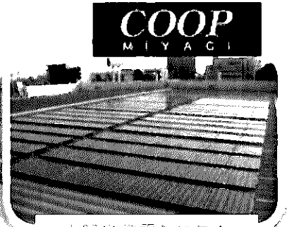
太陽光発電システム
